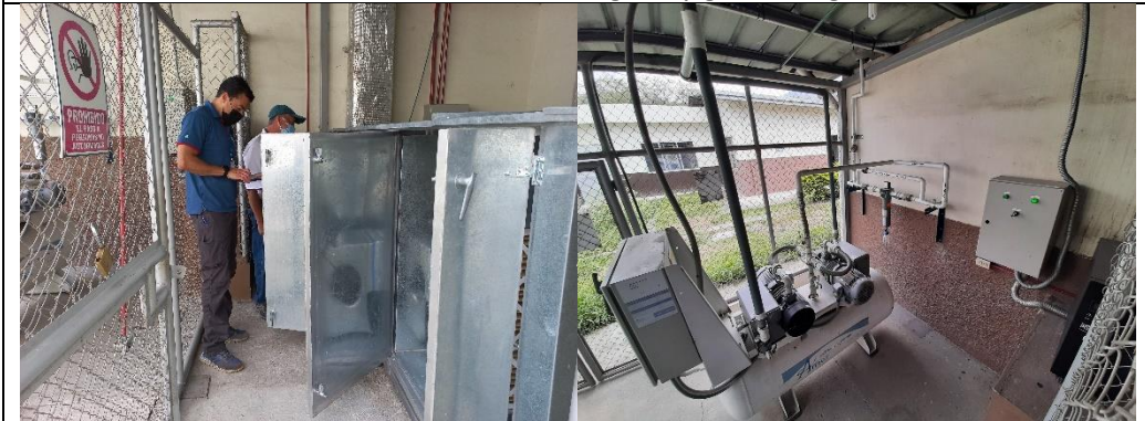
Área de equipo de purificación de aire
