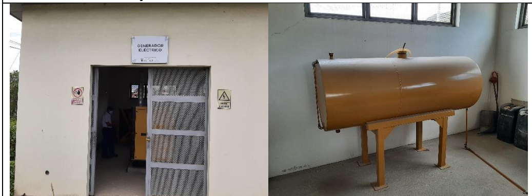
Áreas de generador eléctrico
