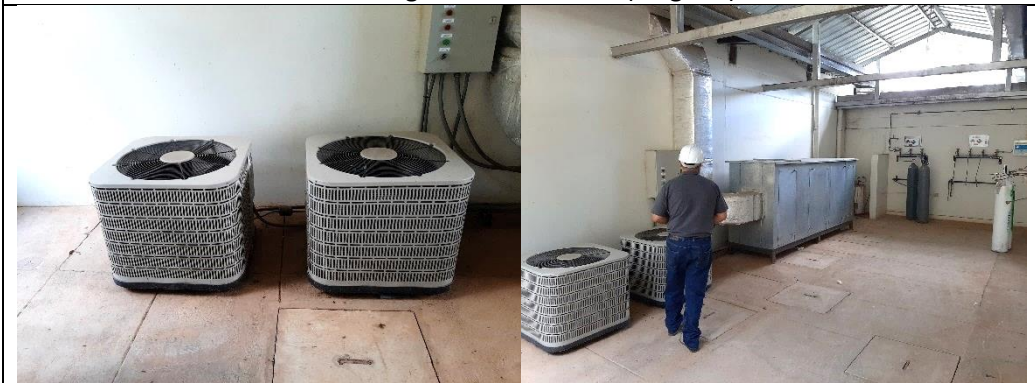
Área de equipo de purificación de aire
