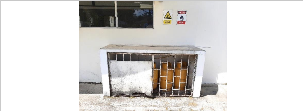
Área de almacenamiento de GLP de cilindros 10 Kg.
