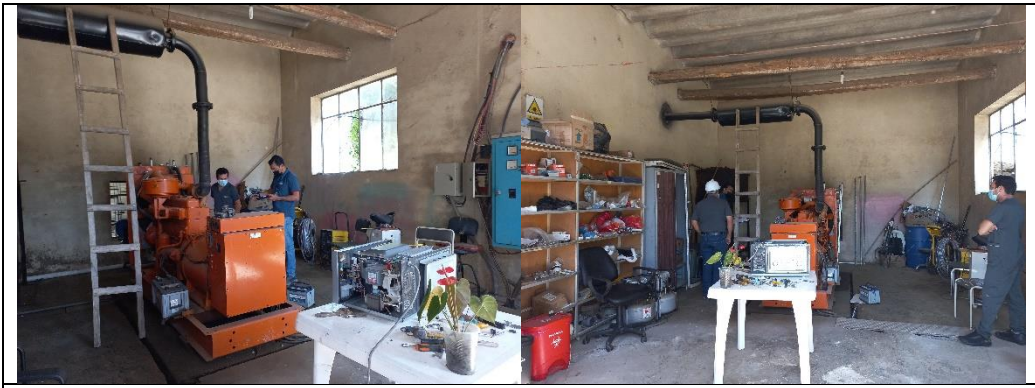
Área de generador eléctrico
